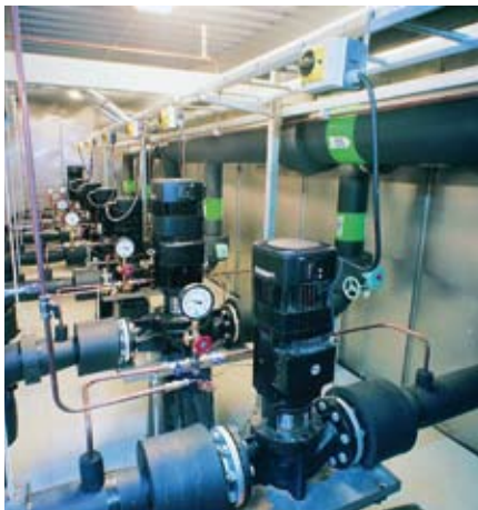
Offene Bus-Kommunikation mit LONWorks senkt die Installationskosten von Pumpen und ermöglicht den bidirektionalen Datenaustausch.
